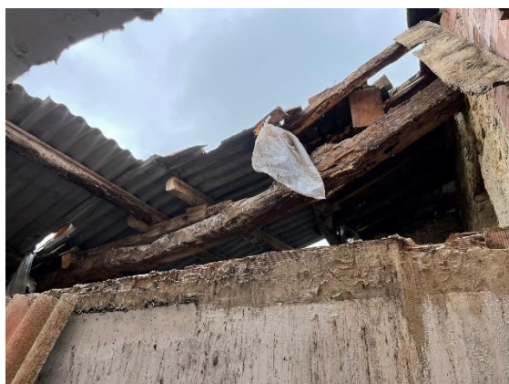
Elementos estructurales a punto de colapsar
