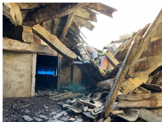
Elementos estructurales ya colapsados
